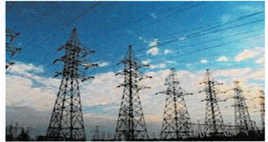
เสาไฟฟ้า
